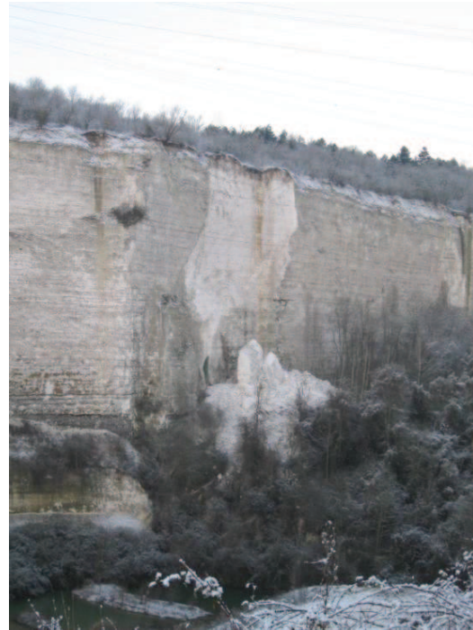
Photo 7 : Vue de l'écaille rocheuse éboulée le 20/12/2012 (Photo LAFARGE prise le 16/01/2013)
