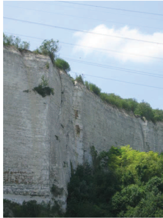
Photo 8 : Vue de l'écaille rocheuse avant éboulement, le 10/06/2006 (Photo LAFARGE)
