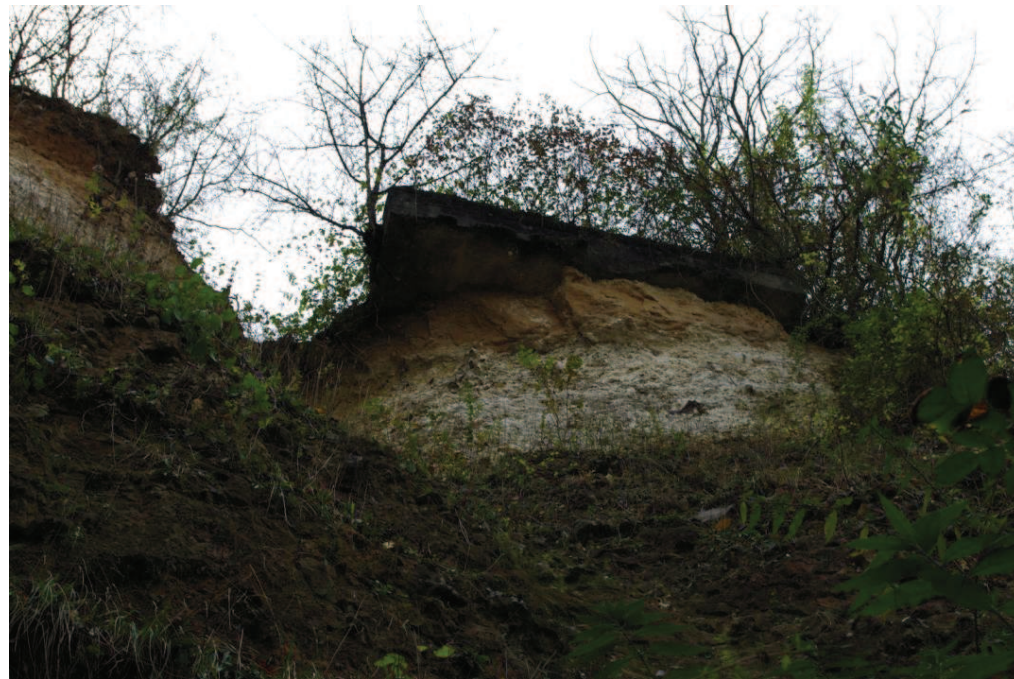
Photo 3 : Erosion préférentielle au droit d'un quai de jetée (point P7)
