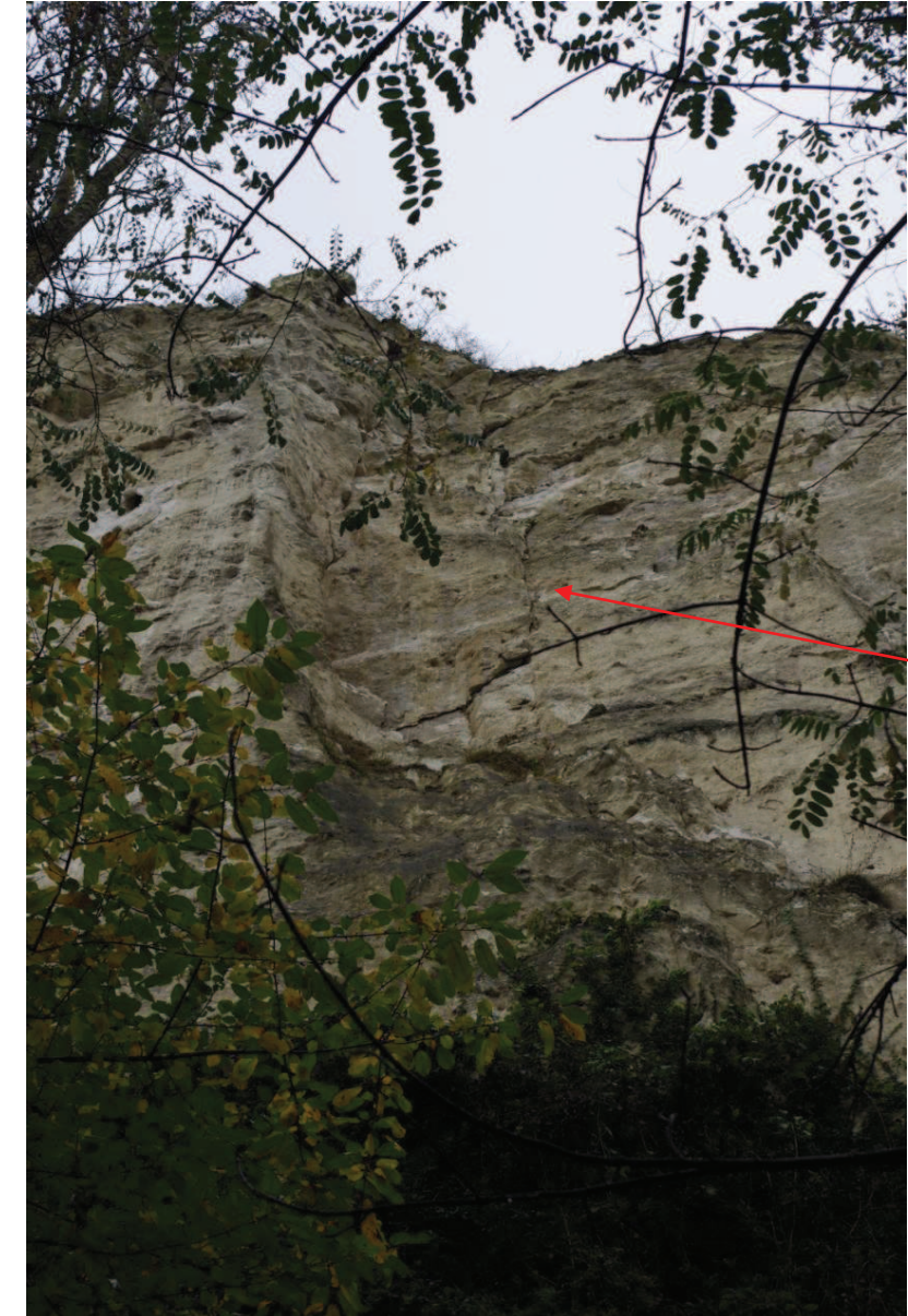
Photo 6 : Panneau avec fractures ouvertes en situation instable (P21)
